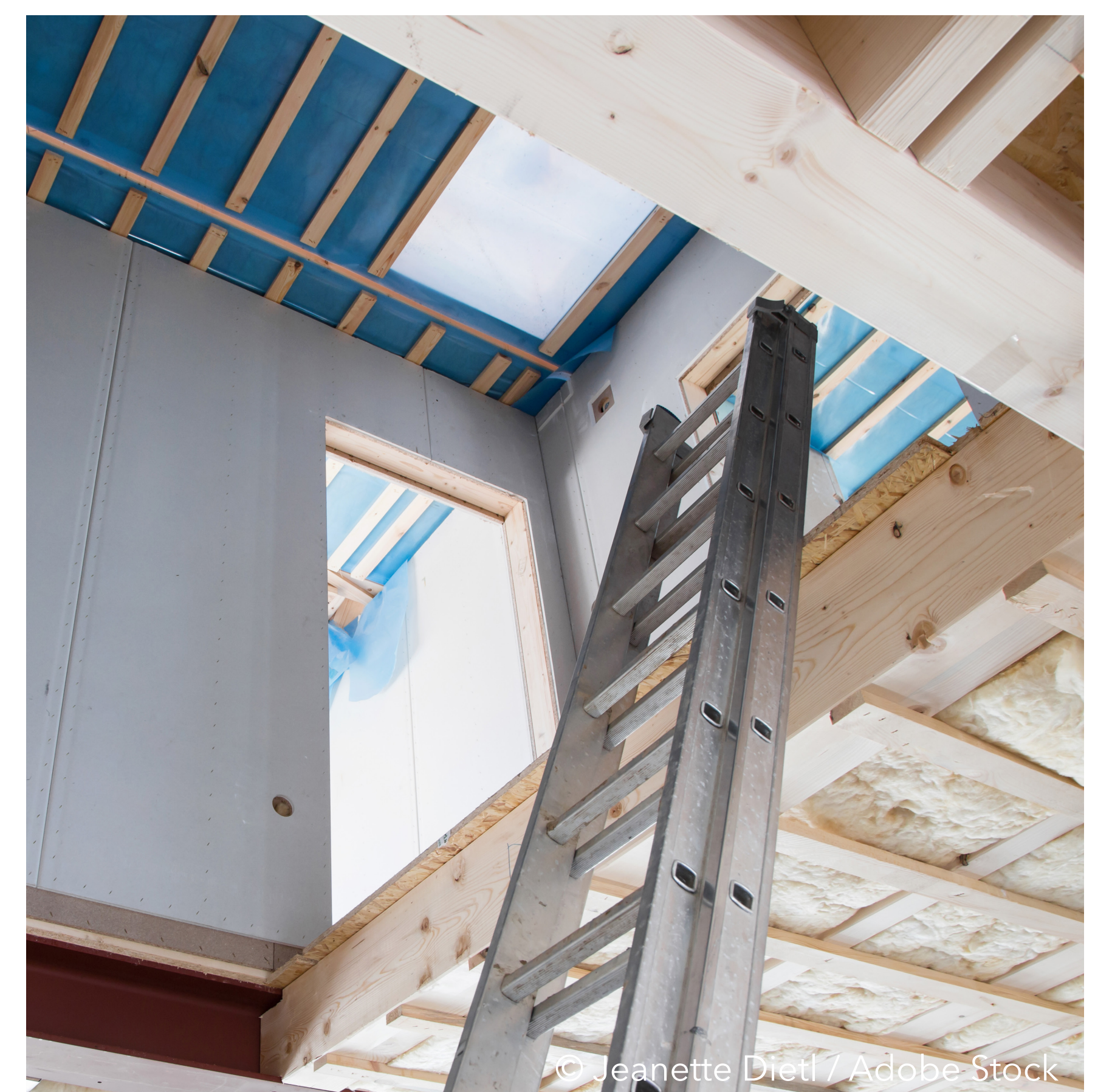
Dämmung verhindert Aufheizen und Auskühlen
